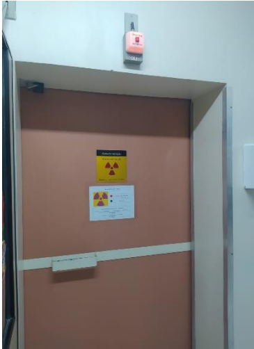
Figura: 15 Sinal luminoso da porta
