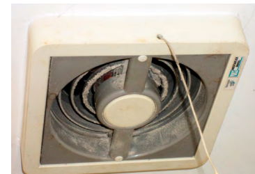
Figura 80. Exaustor da câmara escura precisando de limpeza
