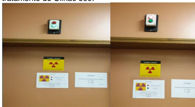
Figura 6. Luzes de advertência porta da sala de tratamento do Clinac 600.
