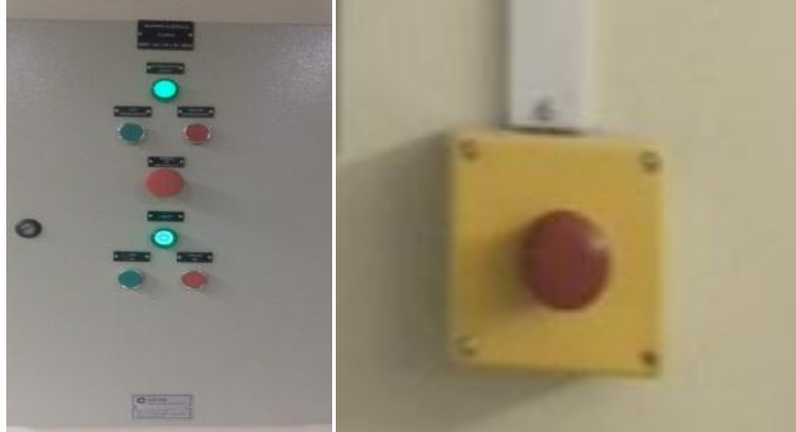
Figura 15. Botão de emergência da sala de comando do aparelho Trylogi
